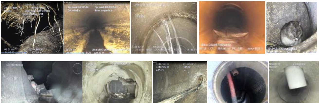
Slika 5: Prikaz posameznih primerov poškodb in posebnosti kanalizacijskega omrežja, posnetih pri pregledu s TV-kamero
