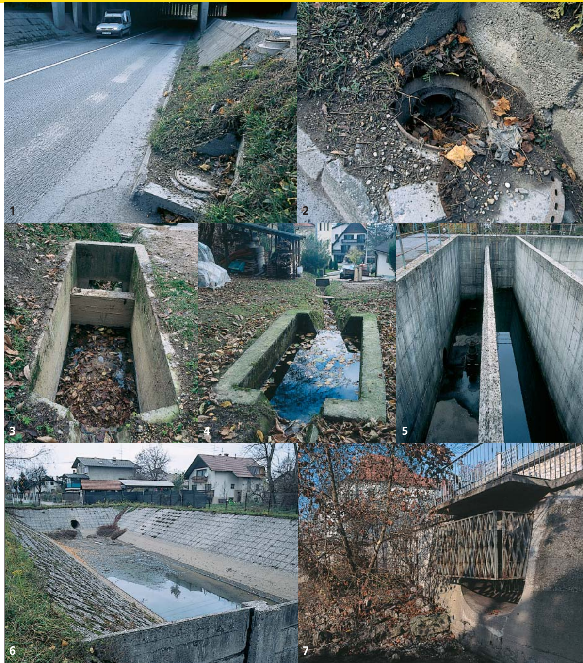
Slike 1–4: z listjem zamašeni objekti padavinske kanalizacije onemogočajo nemoteno odvajanje padavinske vode, sliki 5–6: objekta, v katerih se pred izlivom v vodotok od padavinske vode ločijo lahke tekočine (olja, naftni derivati...), slika 7: objekt, ki v primeru preveč intenzivnih padavin, omogoča odtekanje odpadne vode iz mešanega kanalizacijskega sistema, direktno v vodotok.
