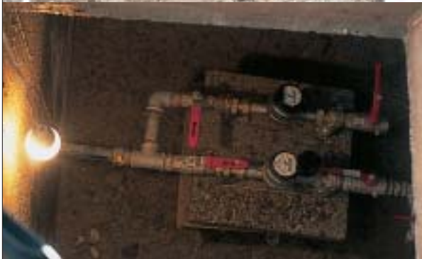
Fotografija neurejenega vodomernega jaška (zgoraj), urejeno vodomerno mesto (spodaj).
