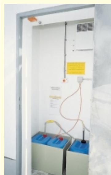
Plinski klor, ki se skladišči v jeklenkah (slika 1), se preko avtomatskega krmilnika (slika 2) dozira v odvisnosti od pretoka vode in željene količine prostega klora. Sodobnejši klor-dioksid, ki ga že uvajamo, se pripravi v črpališču, krmiljenje pa je že v napravi sami (slika 3).
