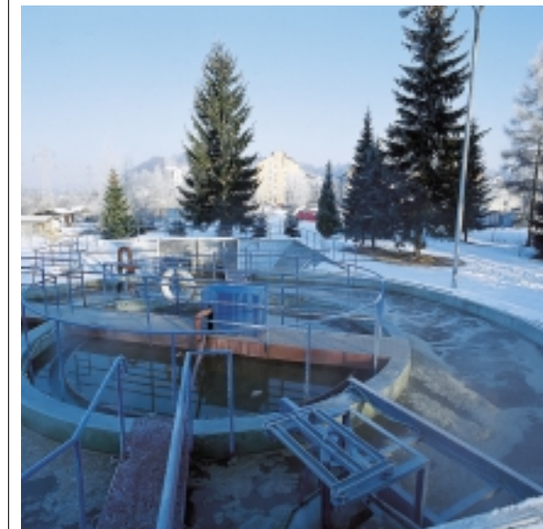
Rekonstrukcija čistilne naprave Črnuče bo v letu 2000 največji investicijski poseg na naših objektih.
