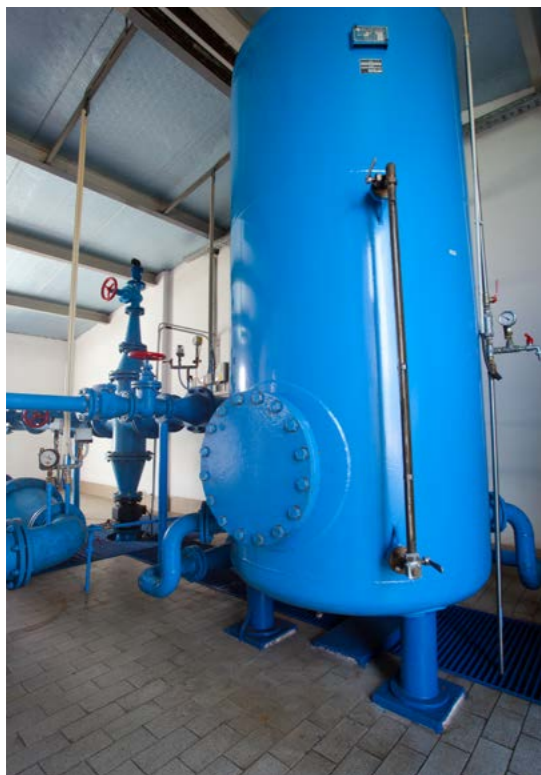
Tlačna posoda v vodovodnem objektu
