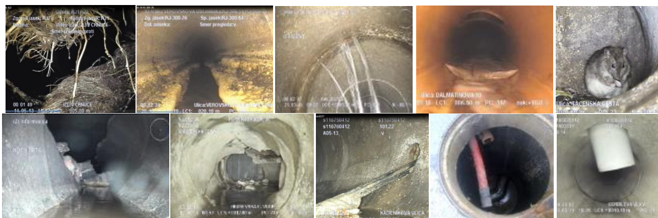
Slika 3: Prikaz posameznih primerov poškodb in posebnosti kanalizacijskega omrežja, posnetih pri pregledu s TV-kamero
